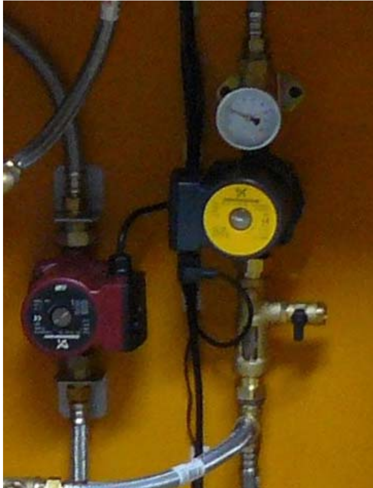
Fig. 3.8. Detalle de posición de la bomba de circulación del circuito secundario.
